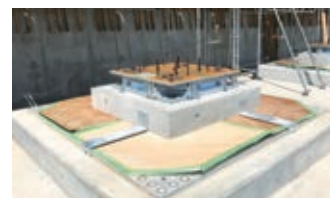
写真1 免震装置(ベニヤ板で保護している部分も装置の一部です)
